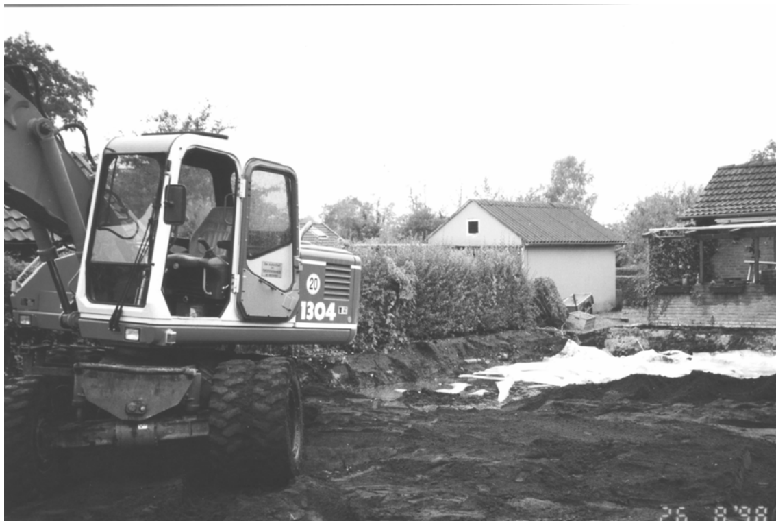
Abb. 4: Garten während der Sanierung: Der Boden wurde bis zu einer Tiefe von ca. 0,75 m vollständig ausgekoffert und zur Entsorgung abtransportiert
