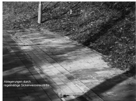
Abb. 2: Sickerwasseraustritte auf Wegen der Anlage
