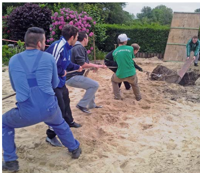
Voller Einsatz beim Entfernen des Fundaments: Kräftig ziehen! Jugendliche beim Ausschachten des Spielplatzgeländes im Kgv. „Grullbad“.
